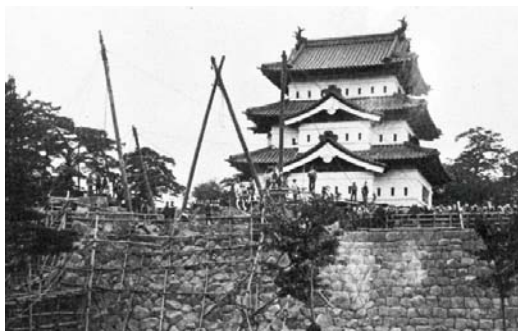
100年前の天守曳屋／人力で天守を曳屋していますが、今回は機械を用います。
